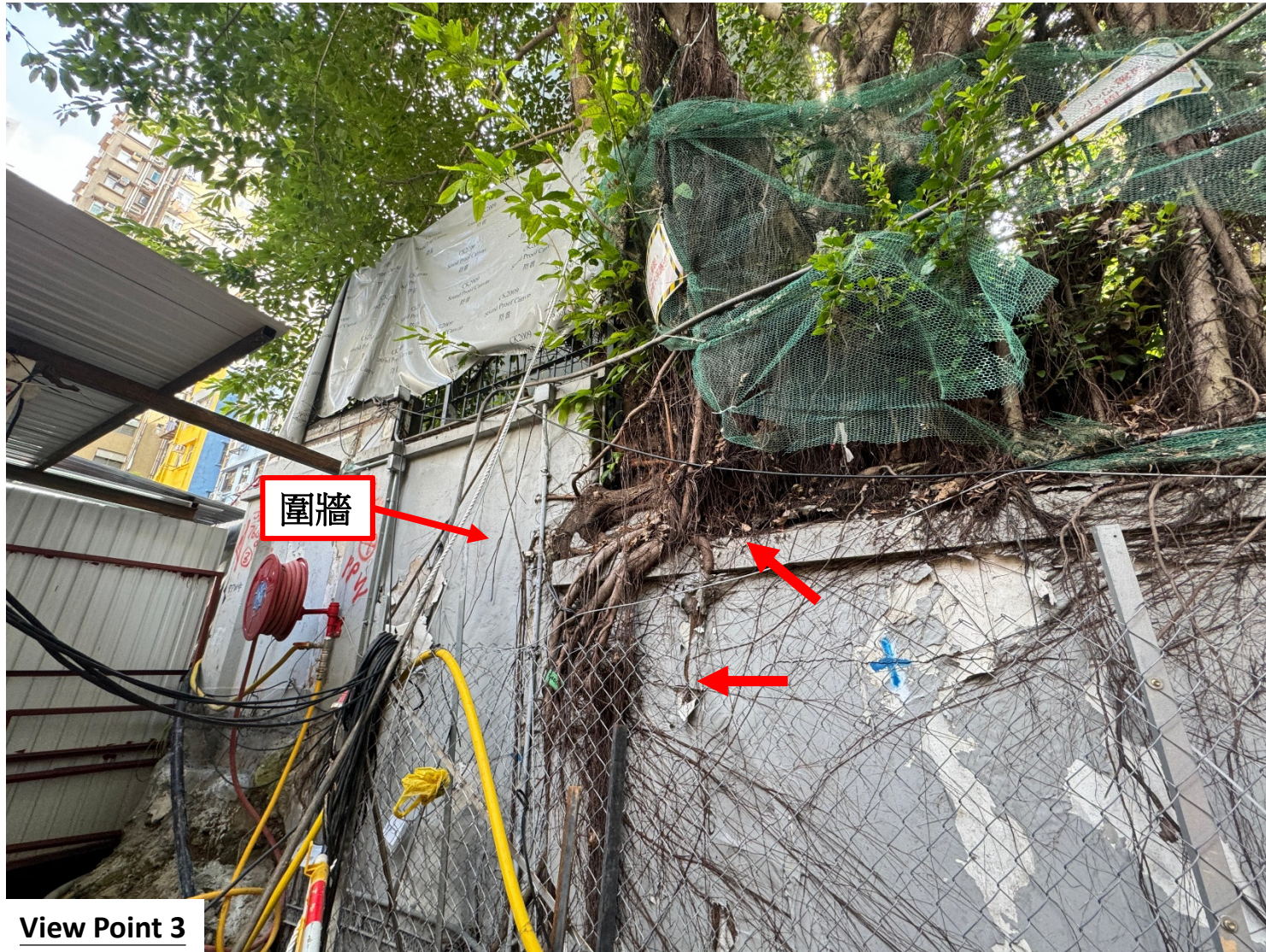
圍牆上的多道裂縫 (項目用地內)
