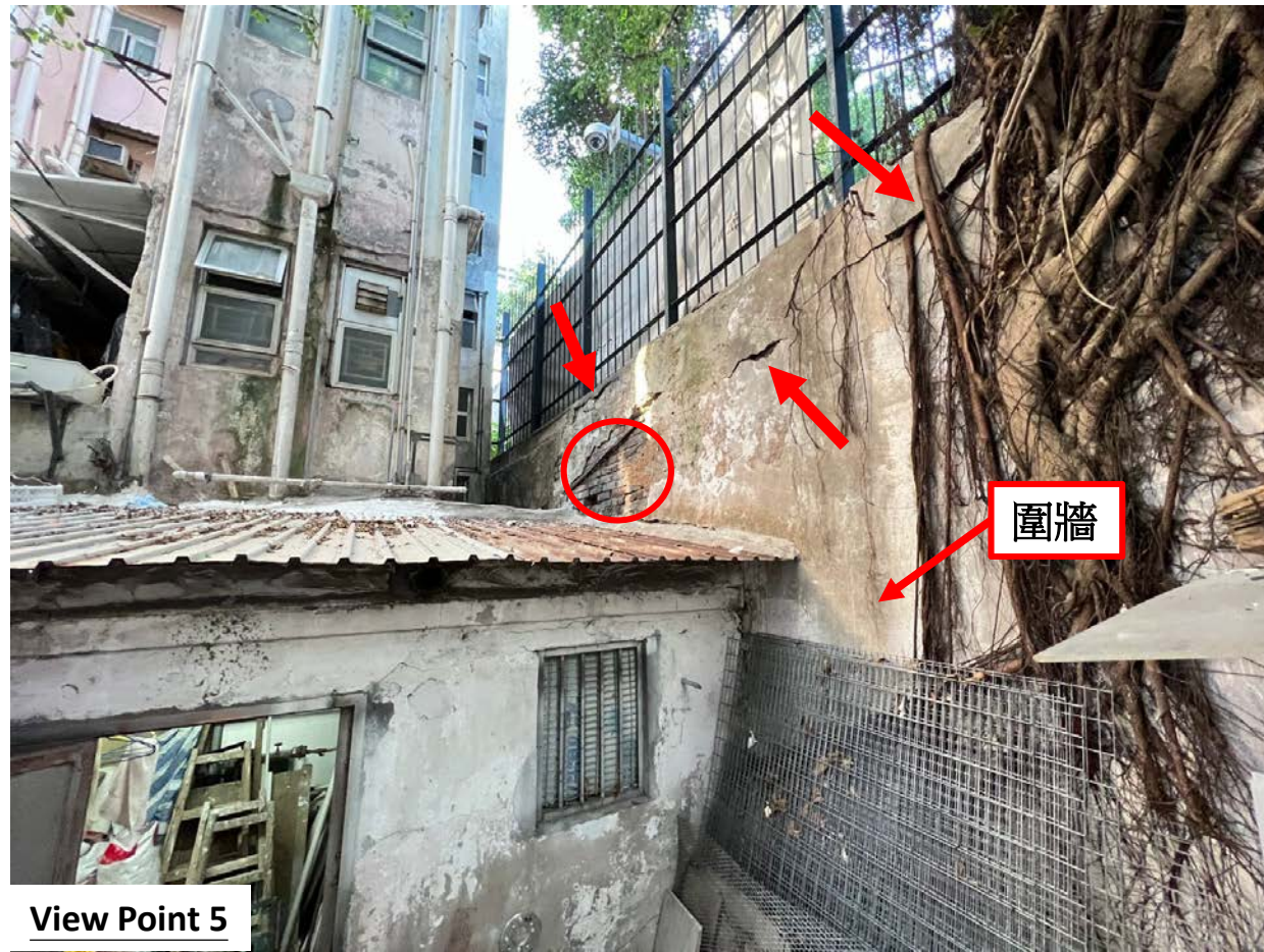
圍牆上的多道裂縫 (項目用地外)
