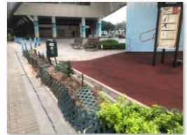
08藍尼地城游泳池休憩處_花槽圍欄破爛02
