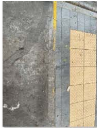
07荷李活道公園_黃色欄線出現脫色
