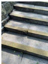
09香港佐治五世紀念公園_石級樓梯出現破爛
