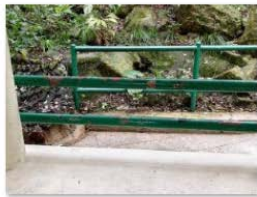
16城西公園_涼亭鐵欄掉漆嚴重
