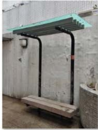
15第三街休憩處_長椅日久失修及上蓋鐵枝掉漆嚴重
