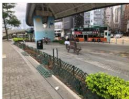
08藍尼地城游泳池休憩處_花槽圍欄破爛03
