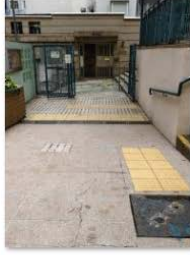
14第三街遊樂場_近居仁里門口處地磚出現裂縫
