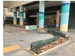
08藍尼地城游泳池休憩處_花槽圍欄破爛01
