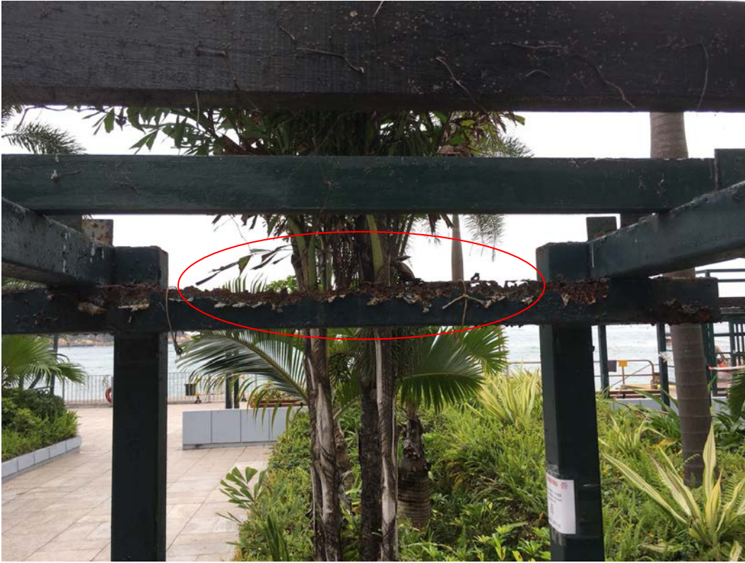
上蓋支架嚴重鏽化
