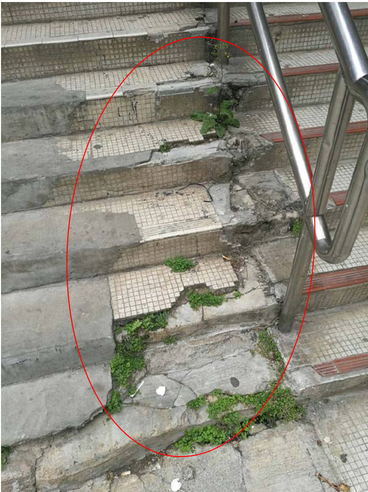
梯間裂縫已長出植物，影響結構安全
