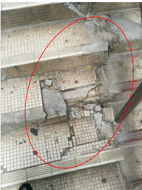
樓梯石屎崩落
