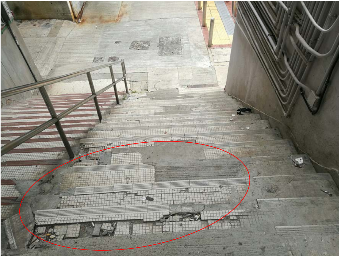
樓梯多處有裂縫
