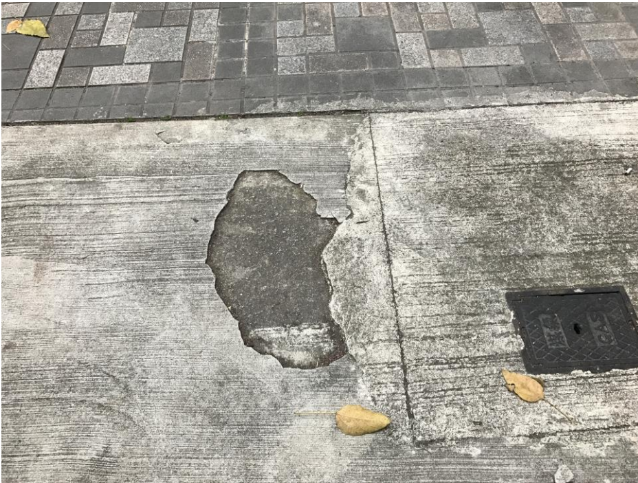
路面多處出現破損、裂痕
