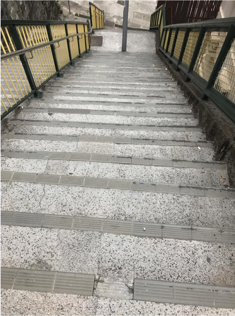
樓梯石屎出現裂痕破損
