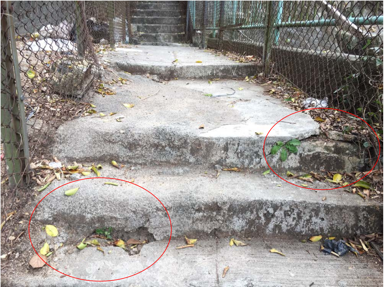
樓梯石屎崩落
