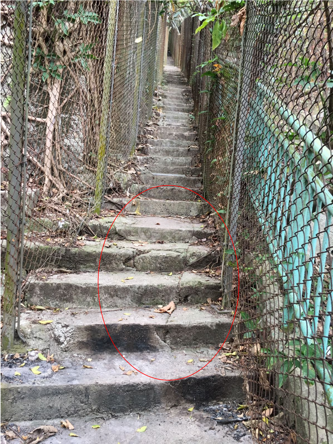
樓梯多處有裂縫
