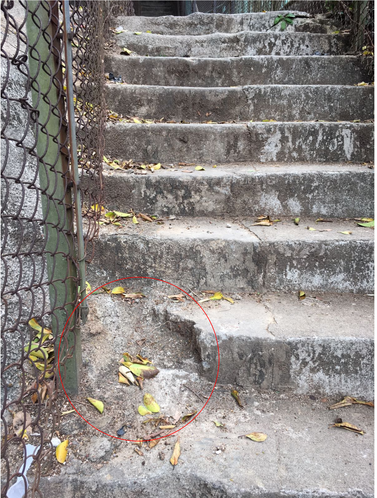
樓梯石屎出現缺口
