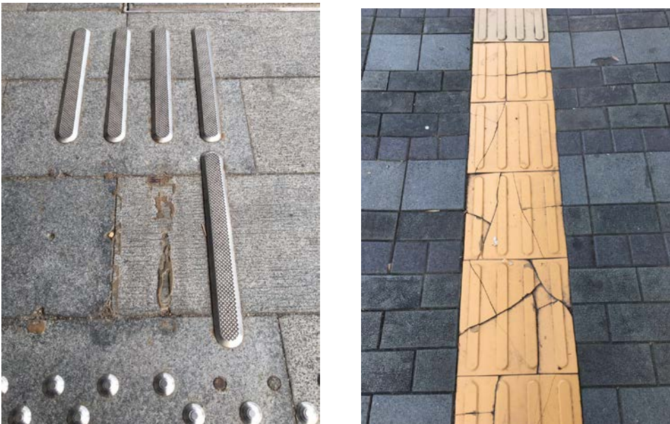
2. 中山紀念公園內導盲道破損，影響美觀。
