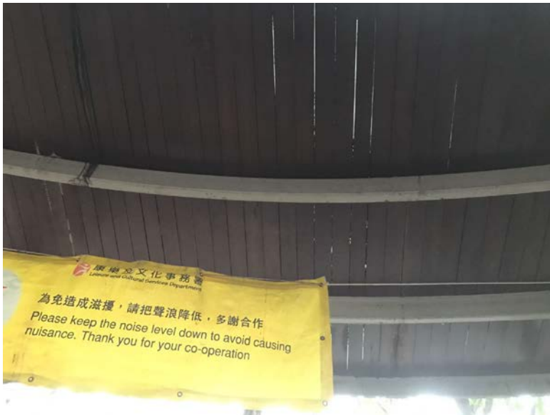
4. 卑路乍灣公園內擋雨遮陽的簷篷疏漏。
