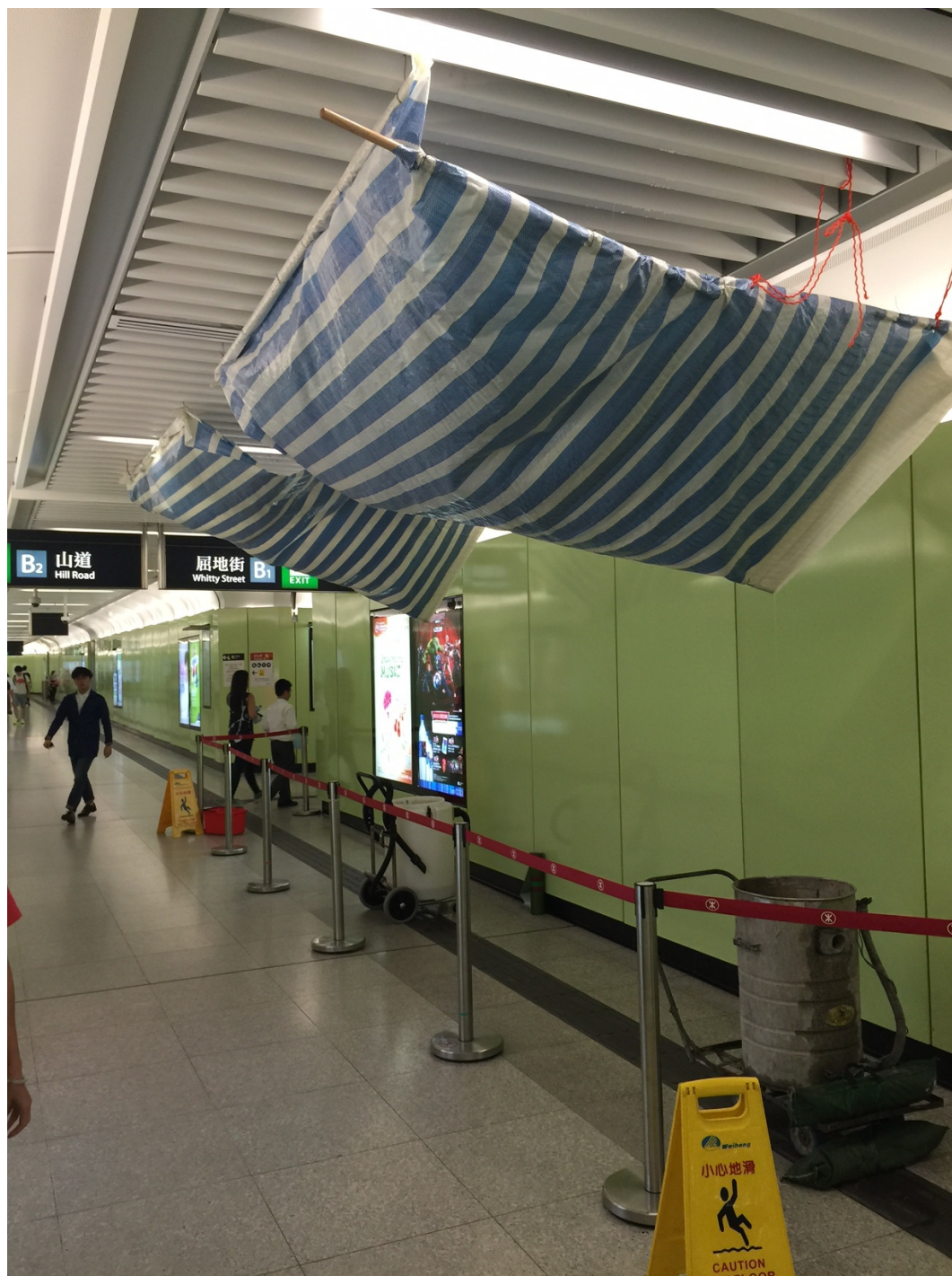
附圖：香港大學站靠近 B1 出口天花的漏水情況
